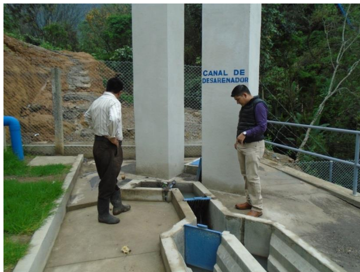
Canal de Rejillas, Planta de tratamiento de aguas de Aldea Santa Rita
